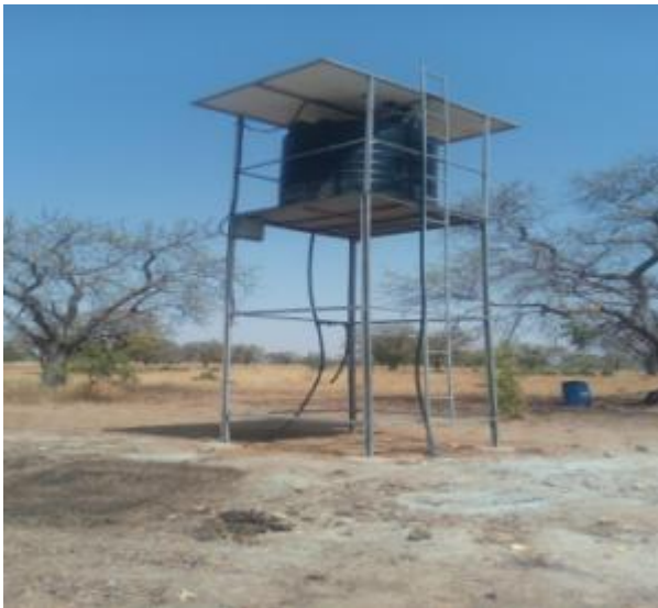
Foto 22 : Solar-Pumpenanlage in Bion
